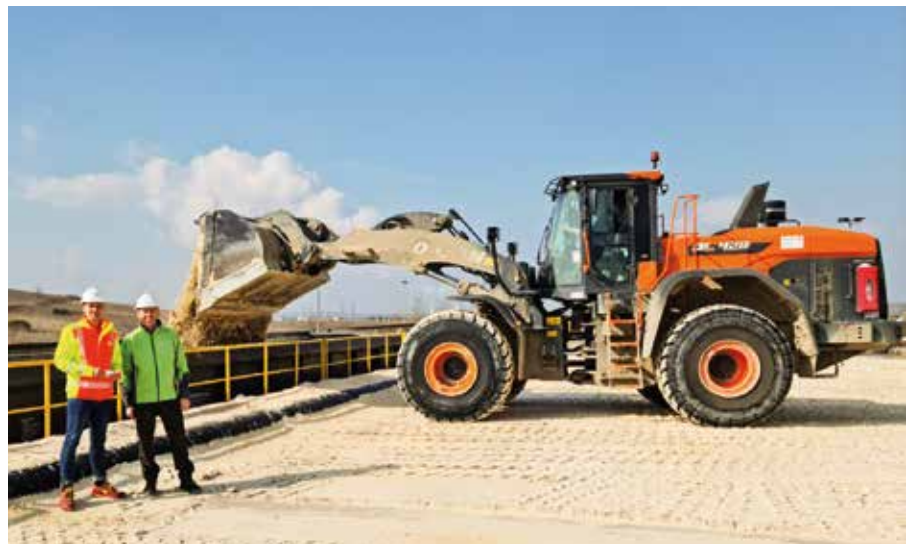
Christian Kubsch ● Hr. Kramer mit Hr. Kubsch bei der Gipsverladung durch einen neuen 24t-Radlader
